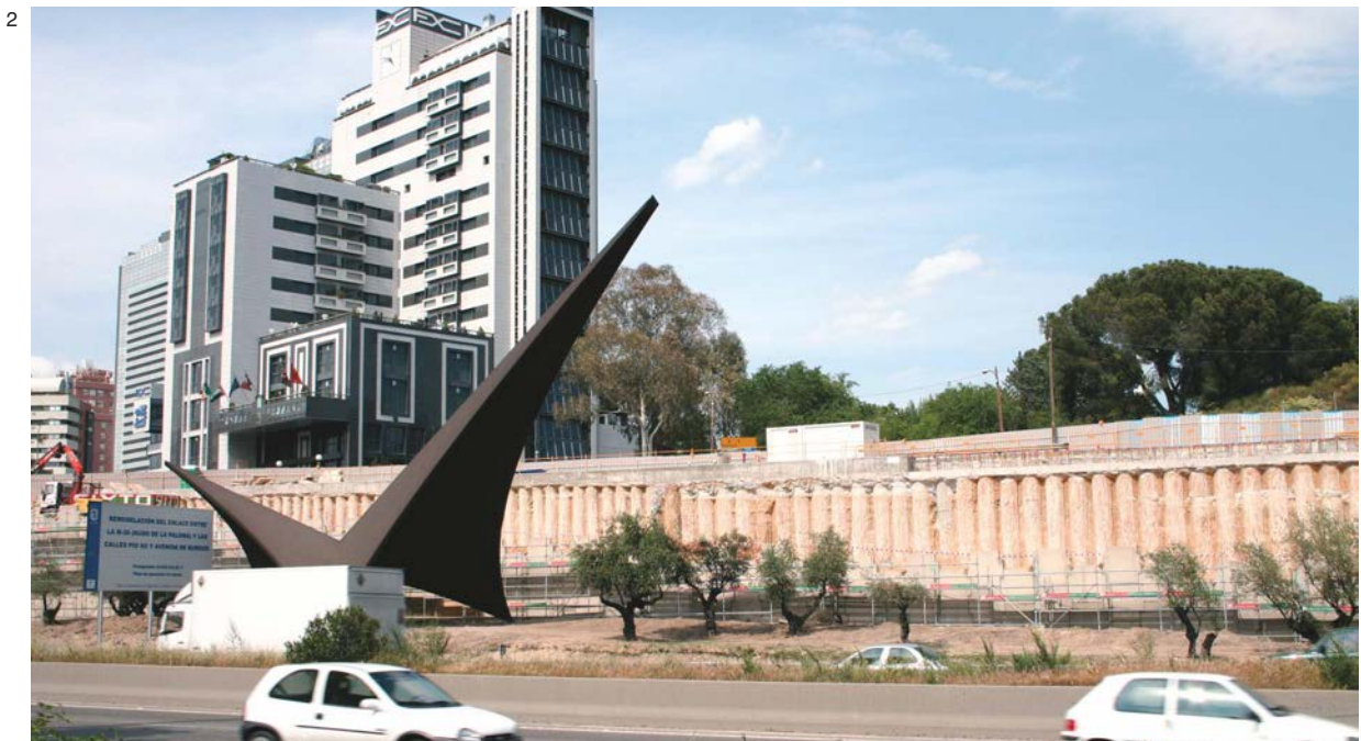
1. Retaining using a pile wall for the El Corte Inglés Shopping Centre in Pamplona (Navarra)
